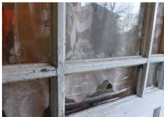
Marode Fenster und Haustüre
