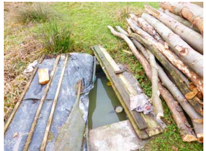
Der Brunnen, 5 Meter tief, ungeschützt und verschmutzt
